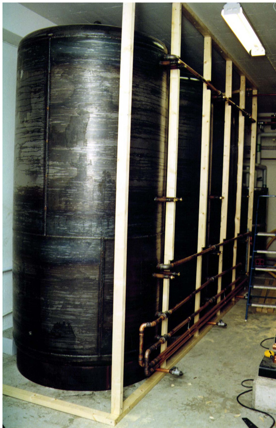
Akkumulatortankarna innan de byggs in och isoleras med lösull
